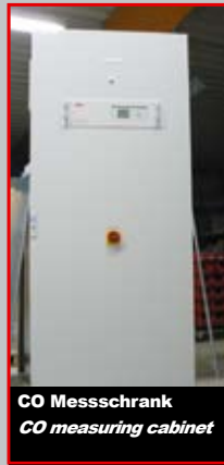
Inertgasanlage mit integrierter CO Messung Inert gas unit with integrated CO measurement
